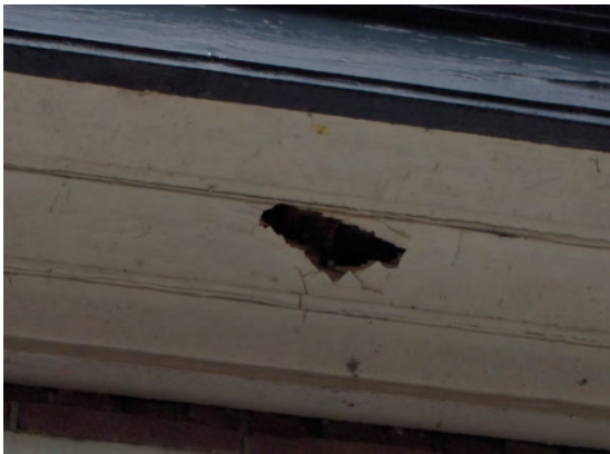
Figuur 4. Gat in de dakgoot van het schoolgebouw
