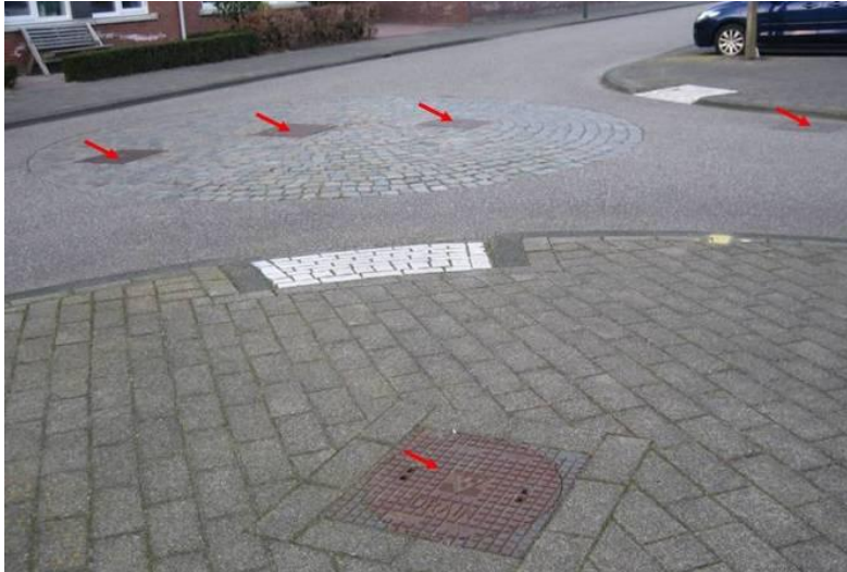
Figuur 16 Hoge dichtheid inspectieputten in Hoep Noord (Schagen), door toepassing Smart Drain
