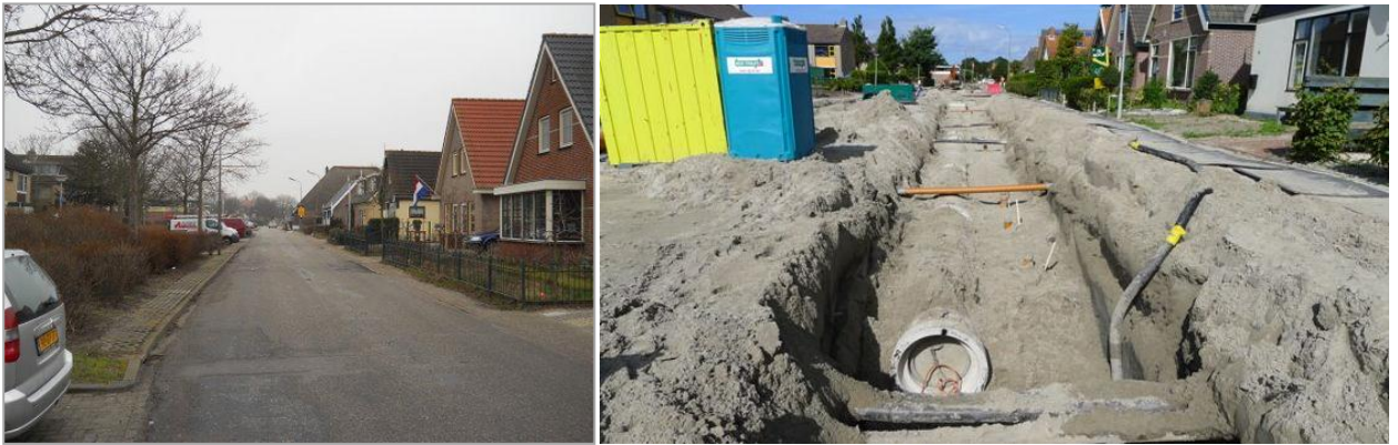
Figuur 12 Dorpsstraat te Sint Maarten (links: vóór herinrichting, rechts: tijdens herinrichting in 2012)
