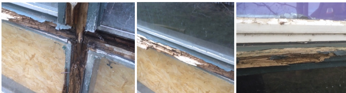
Houtrot kozijnen. Lekkages, tocht, energieverlies, extreme stookkosten
