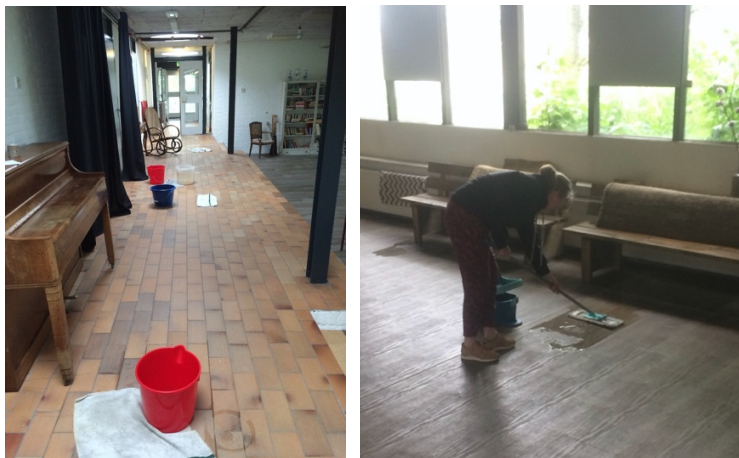
Permanente lekkages. Waterschade interieur en inboedel, annulering activiteiten, risico's (kortsluiting/brand etc.)
