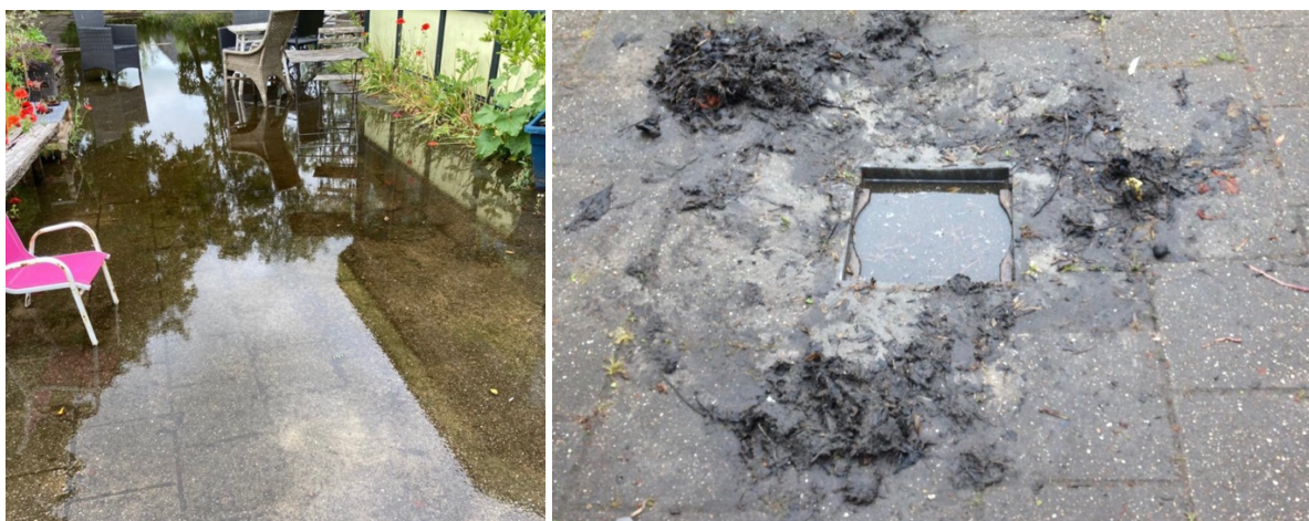
Afwatering schoolplein. Wateroverlast, waterschade gebouw en inboedel. Aansluiting op riool herstellen, leidingen doorblazen.
