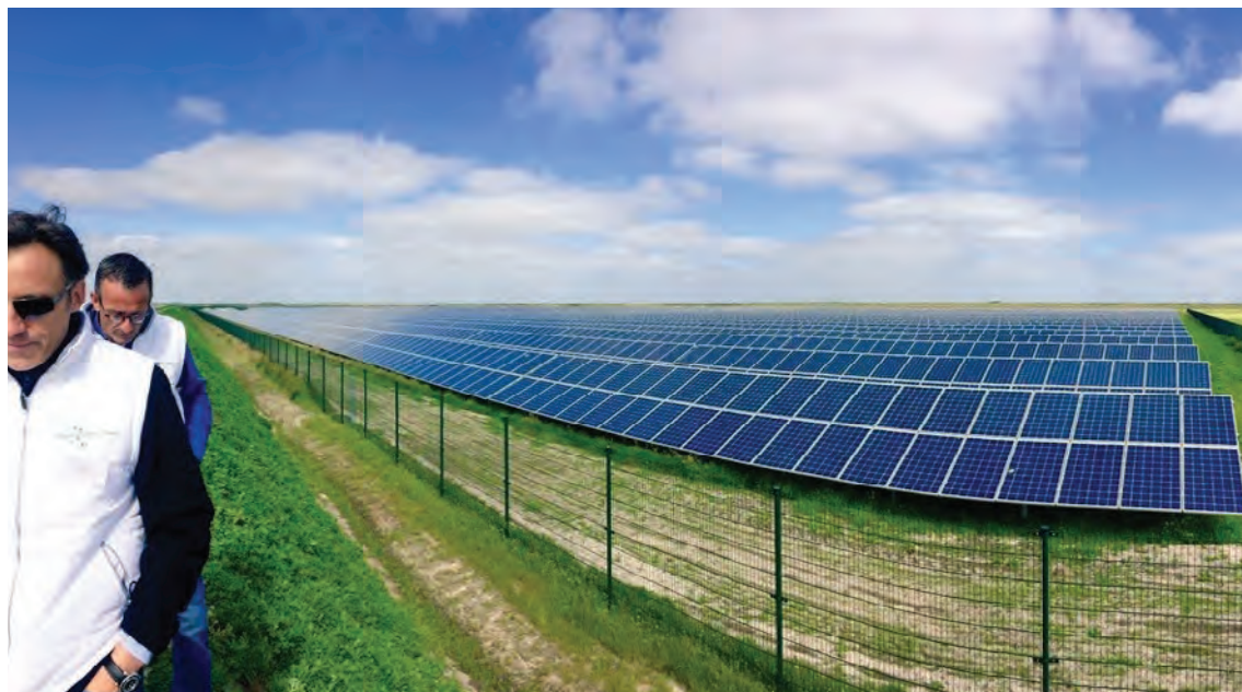
23.000 zonnepanelen voorzien Ameland van elektriciteit zonder CO 2 .
