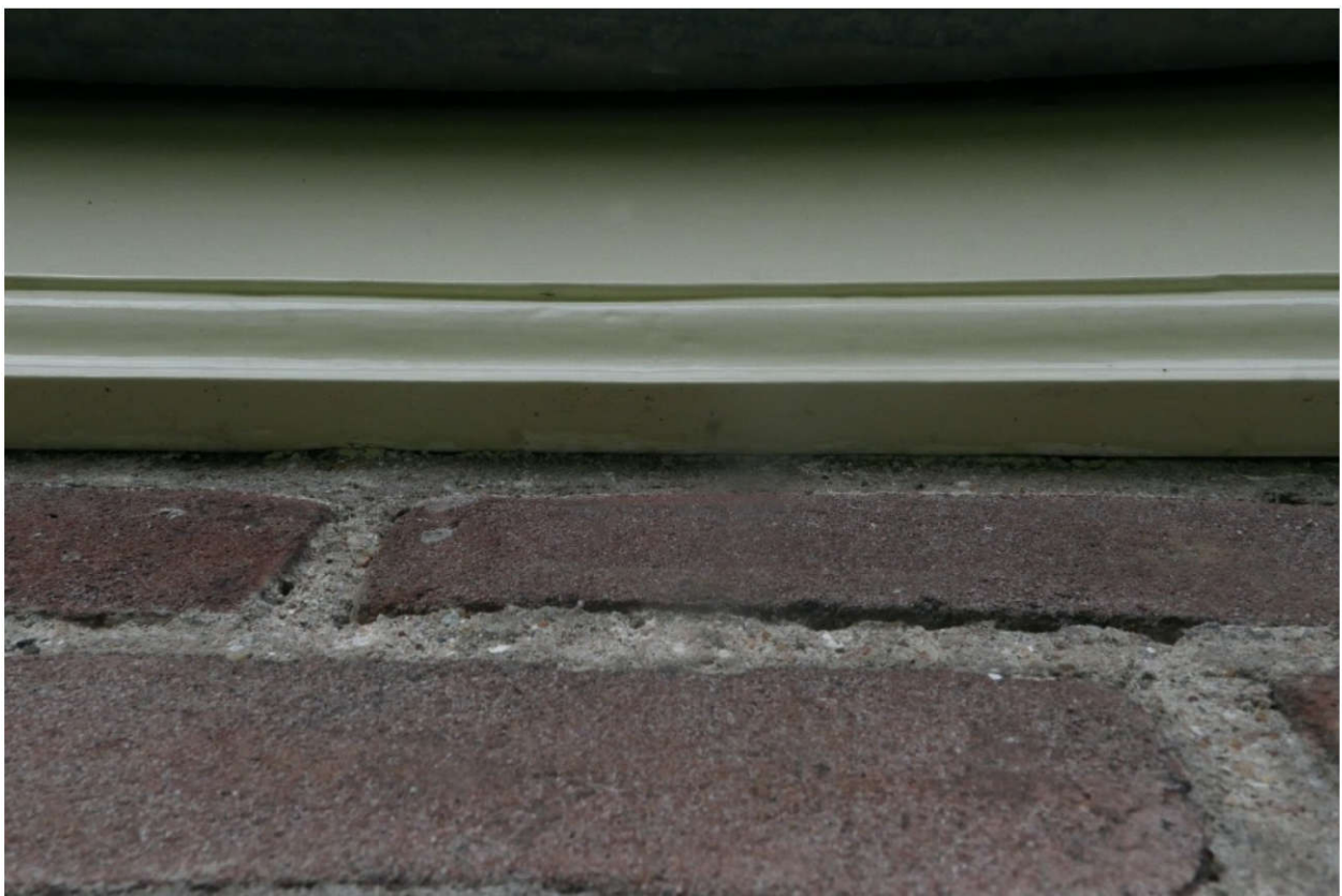
Afb.3: Detail van de gevelbekleding. Zit zonder ruimte tegen de gevel aan. Geen mogelijkheden voor vleermuizen.
