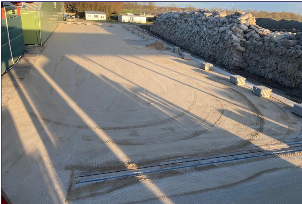
Figuur 14 | In aanleg zijnde vloeistofdichte vloer, goot is reeds niet meer aanwezig (Bron: Next Generation B.V.)
