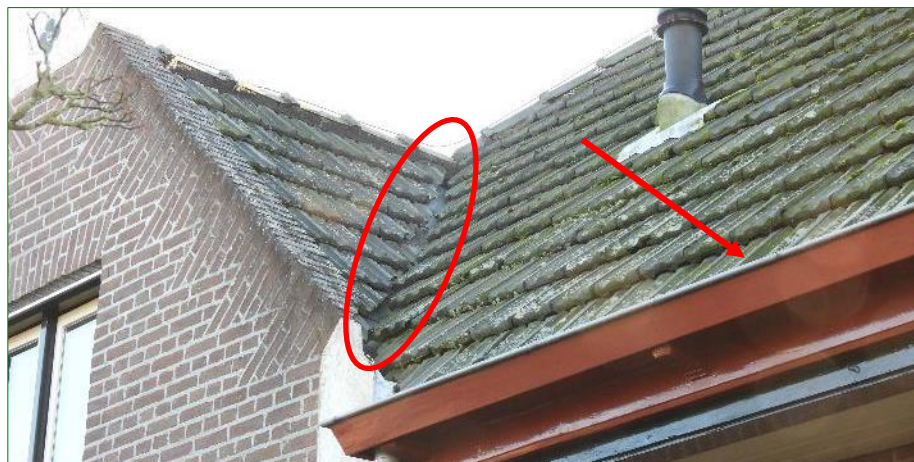
De openingen onder de dakpannen (rode pijl) van de school (boven) en de woning (onder) geven mogelijk toegang tot voor Huismussen geschikte achterliggende ruimtes.
