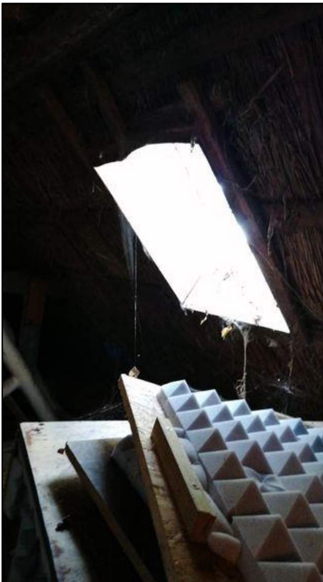
Figuur 9: Opening in het dak waar voorheen een dakraam zat (binnenkant).
