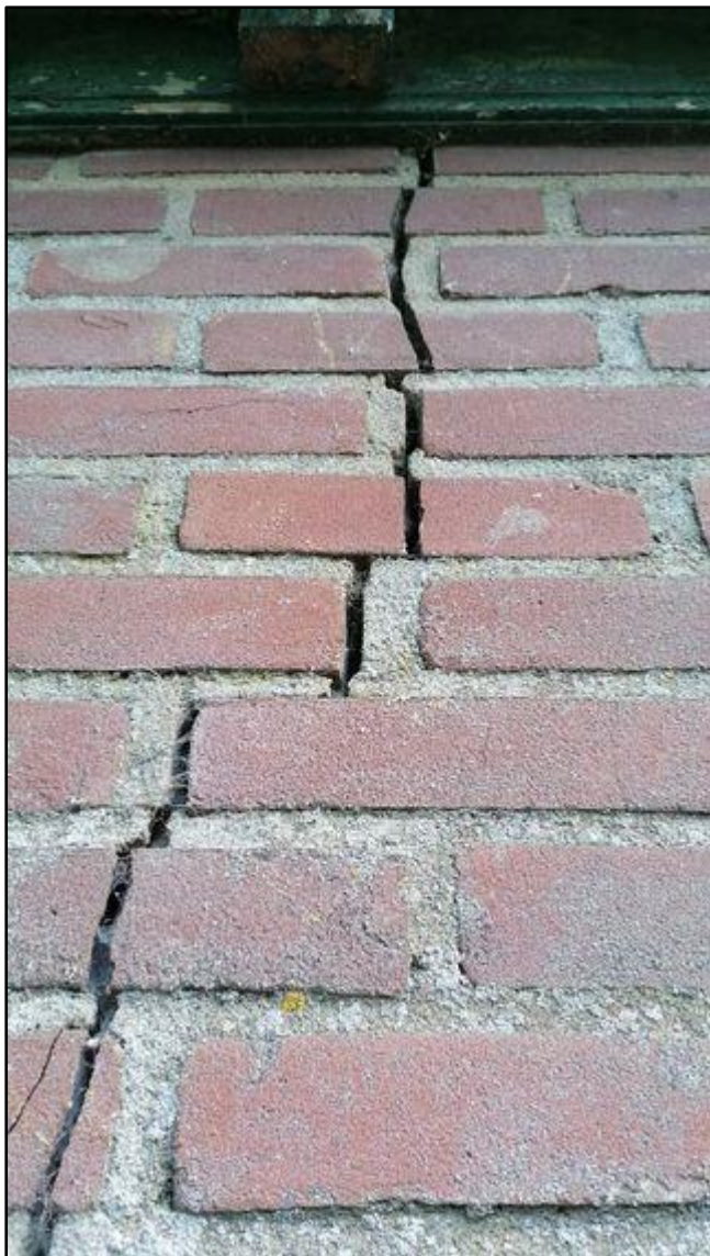
Figuur 6:: Scheur in de gevel biedt toegang tot mogelijke verblijfplaatsen.
