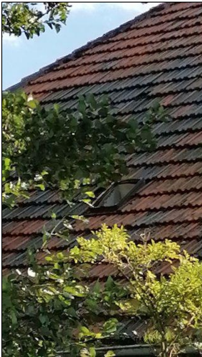
Figuur 8: Opening in het dak waar voorheen een dakraam zat (buitenkant).
